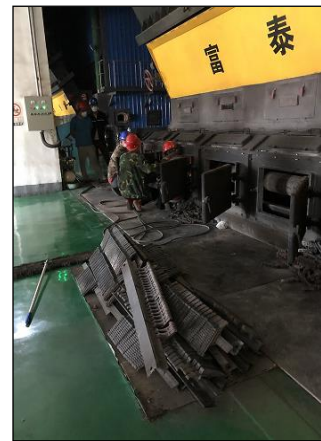
巴彦热源厂锅炉的维护管理（呼和浩特富泰热力股份有限公司）
