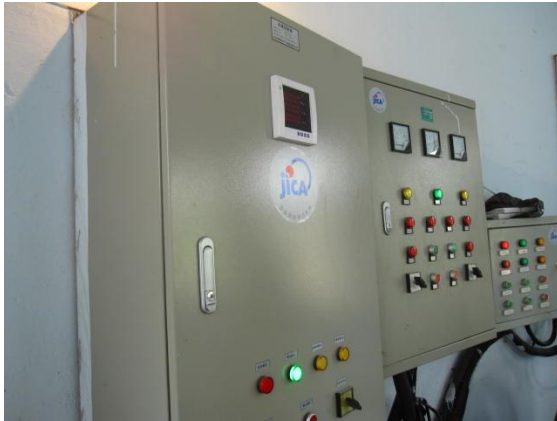
本项目中建设的泵站 设施设备（污水管网建设）
