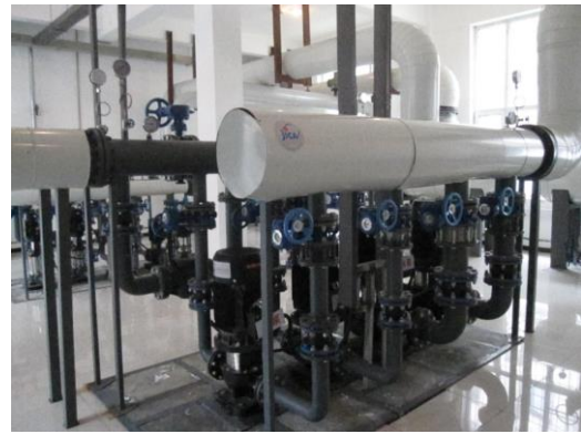
本项目中建设的换热站 设施设备（集中供暖设施建设）
