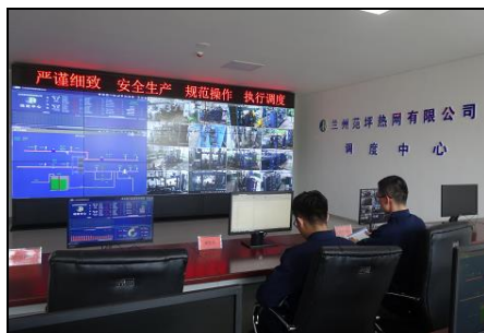
本项目建设的兰州范坪热网有限公司的控制中心
