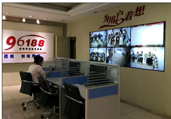
实施单位中控室（石嘴山市）
