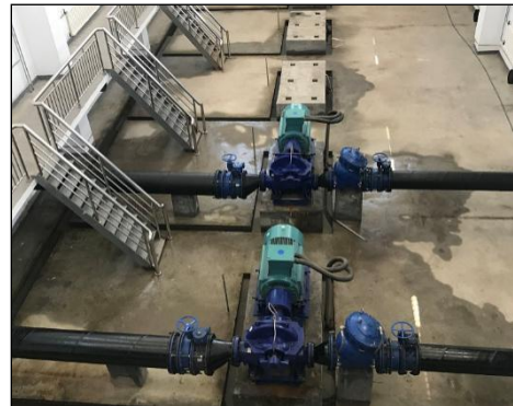
本项目建设的水泵机组
