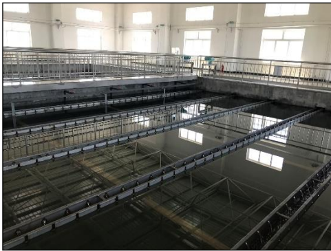
本项目建设的惠农区水厂
