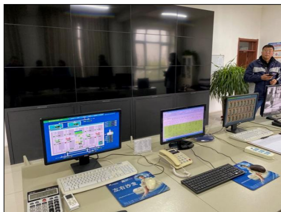
第 5 水厂 (中控室)
