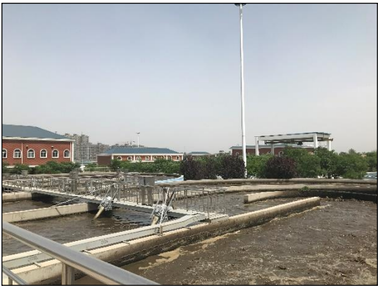
本项目建设的污水处理厂（银川市）
