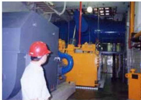
北京十三陵抽水蓄能电站
