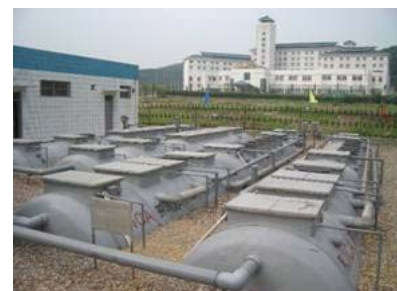
供与された高度処理浄化槽
