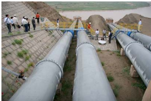
大型灌漑区節水かんがいモデルプロジェクトの 甘肅省蘭州市景泰灌漑区の黄河取水口(送水管 は中側が建設、JICA は流量計等を供与)
