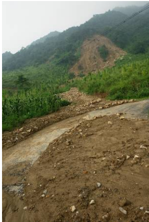
土砂崩れで水路の一部がせき止められました
