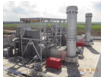
ティラワ発電所
