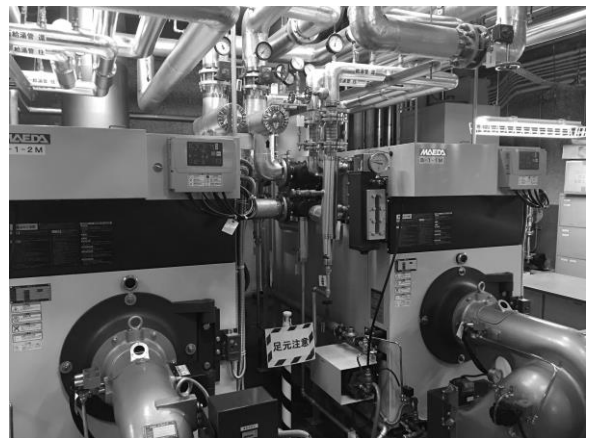
温水ボイラー (食堂棟 暖房・給湯兼用) 【2台・2094kW ・A重油】
