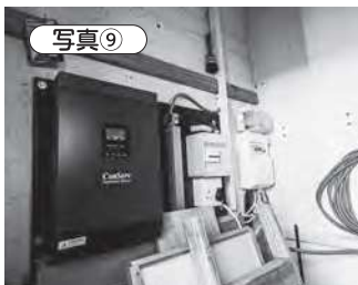
ナミブ砂漠のロッジにあった太陽光発電設備。
