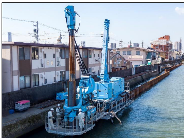
サイレントパイラーを用いた圧入工法による 鋼矢板圧入工事のイメージ
