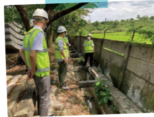
インフラ被害状況調査
