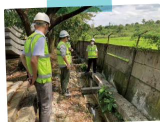
インフラ被害状況調査
