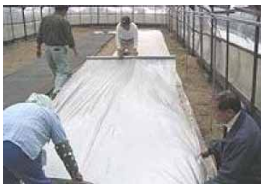
実証ほ場の設置（ハウス）
