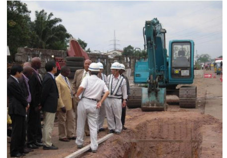
工事再開!日本の緻密な工事にインフラ大臣も興味深々。
