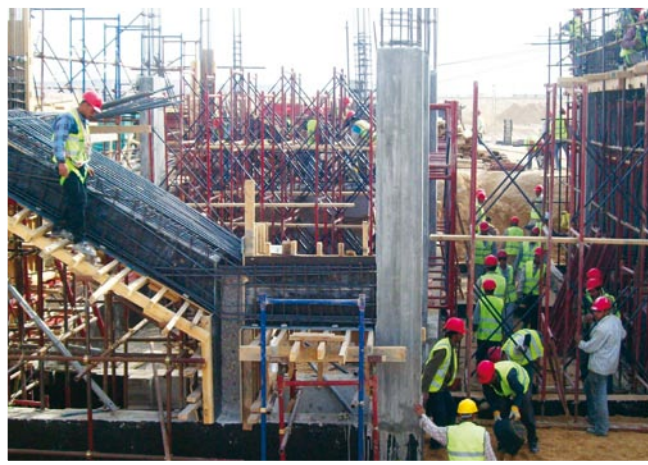
الأعمال الأنشائية فى محطة الطاقة بالكريمات Construction works in Kuraymat Power Plant
