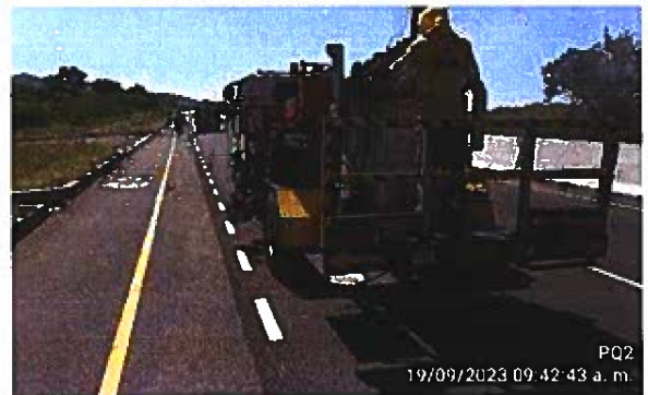
Fig. 10: Personal usando el uniforme institucional en la actividad de colocación de pintura termoplástica. Señalización sobre el pavimento, Est. 7+910. 19-09-2023.
