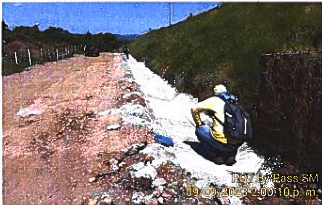
Fig. 3: Medición en conjunto con el contratista de canaleta tipo 6 en pie de talud entre Est. 1+630 a 1+807 LI. 09-09-2023.
