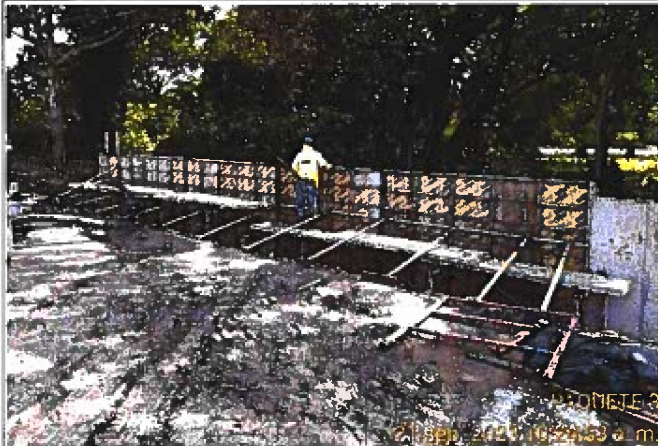
Fotografía 1: Colado de concreto en módulo No. 3 de muro de retención de Est. 14+844.20 a 14+856.30. 21-09-2023.
