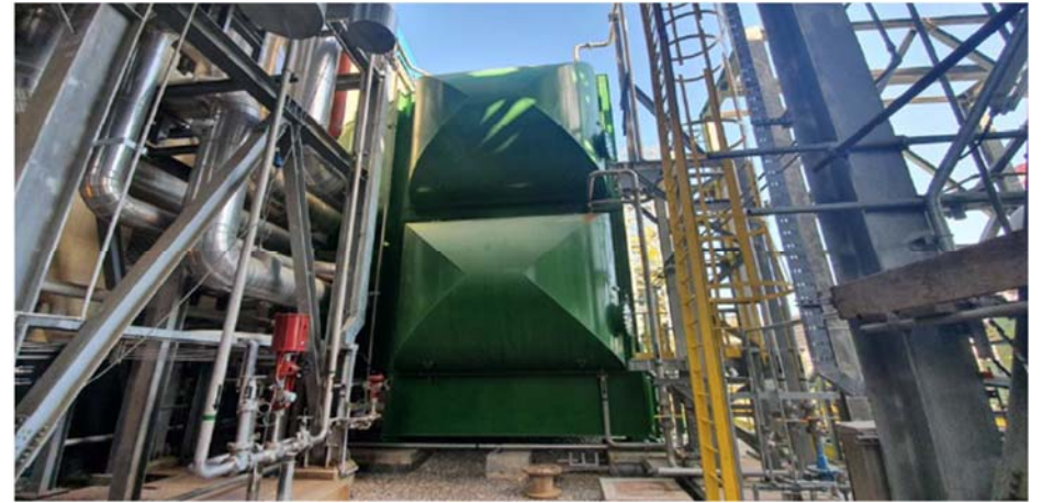
Zone de Condenseur
