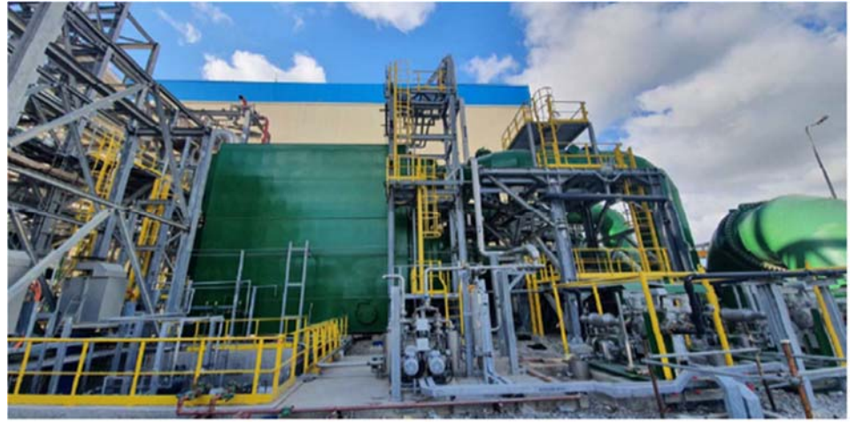
Zone de Condenseur
