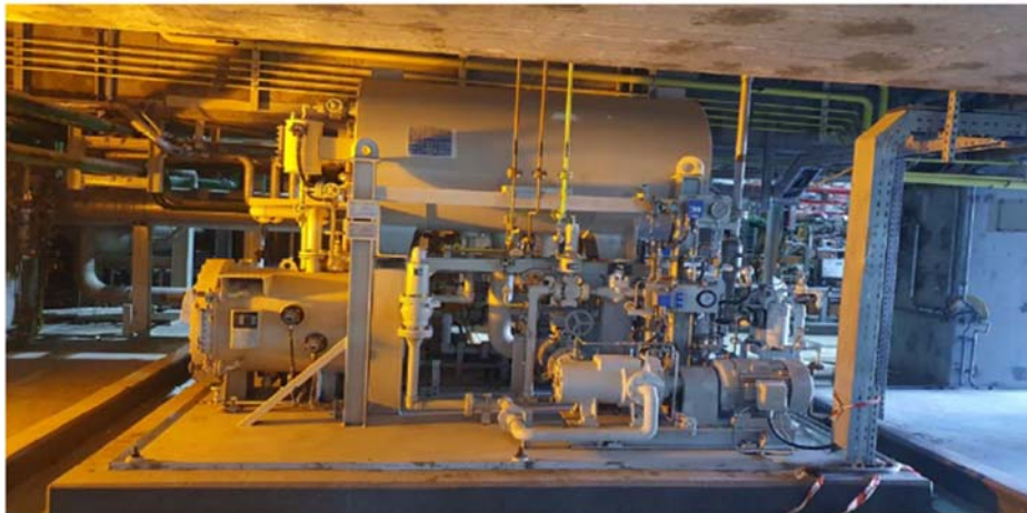
Pompes refoulement d'huile - station de pompage eau de mer
