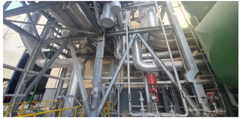
Tuyauterie de vapeur
