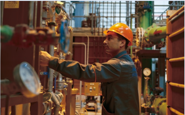
Centrales électriques construites en Ouzbékistan avec des prêts de l'APD du Japon Photo : SHIBUYA, Atsushi / JICA
