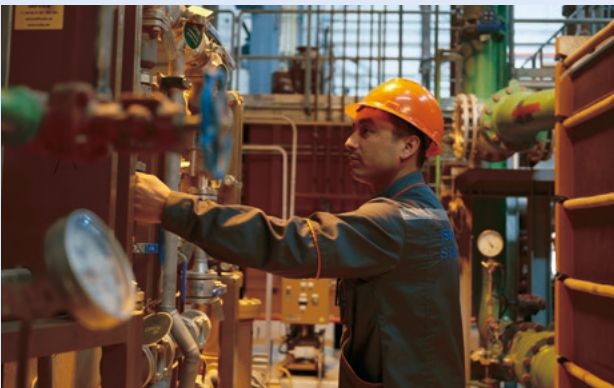
Centrales eléctricas construidas en Uzbekistán con préstamos de AOD de Japón Foto: Shibuya Atsushi / JICA
