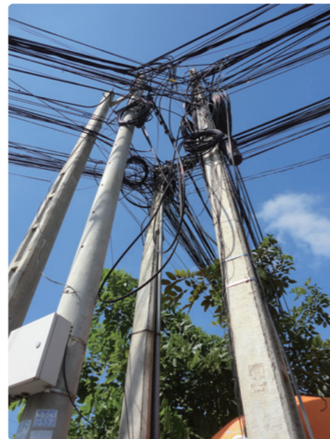
Local access cable (overhead line)
