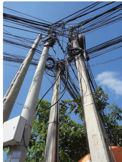
Local access cable (overhead line)
