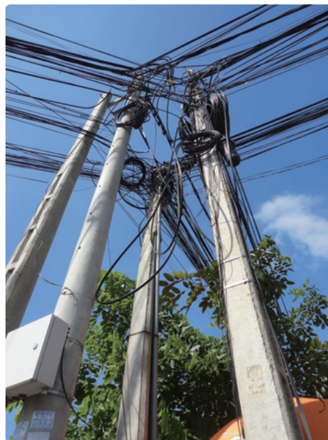
Local access cable (overhead line)
