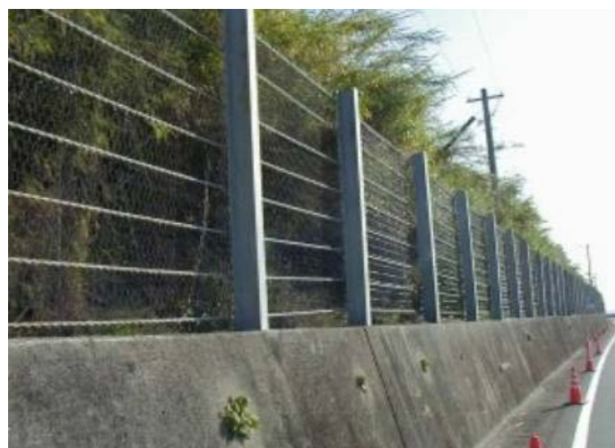
Foto 2-2.2 Valla de Protección contra Desprendimiento
