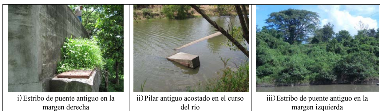
Foto 2-2.9 Estado del Puente Antiguo Paso Real
