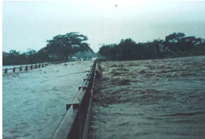
Foto 2-2.1 Estado de antiguo puente Paso Real arrasado
