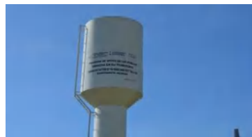
Foto: tanque de agua.
