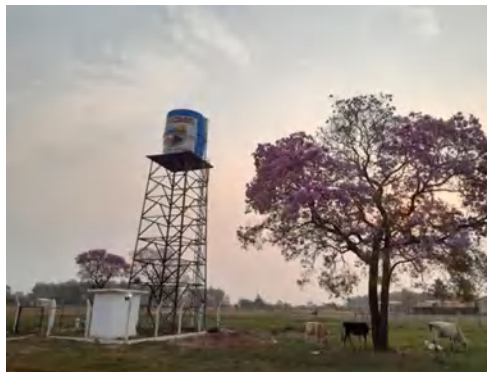
Sistema de Agua Paso Barreto Fuente: Registro fotográfico de trabajo de campo. Equipo consultor. Concepción. Agosto -Septiembre 2020.
