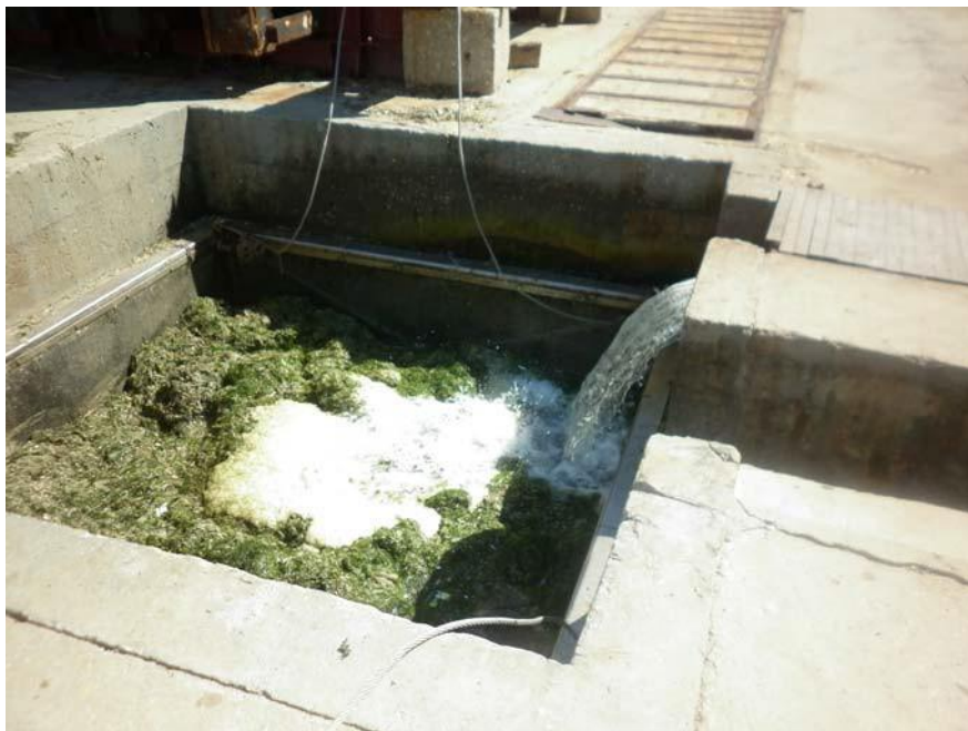
図 44: ポンプユニットのネットに溜まった沈殿物、藻等
