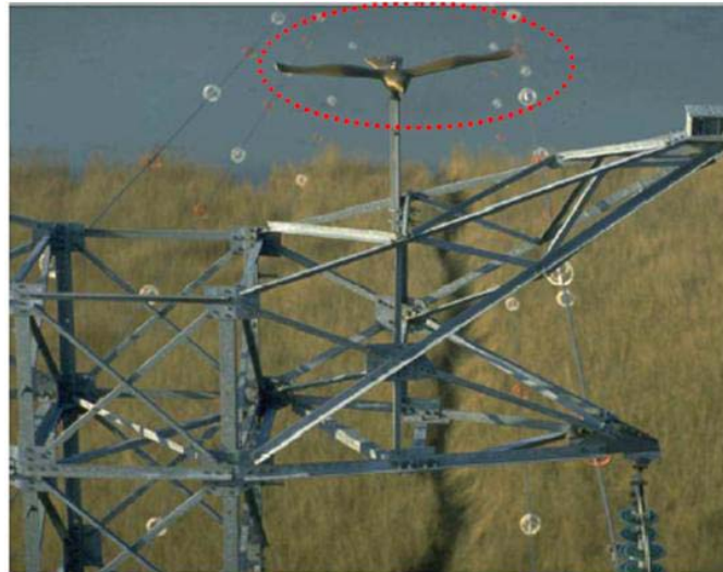
Figure 172 : Pylône équipé par effaroucheur
