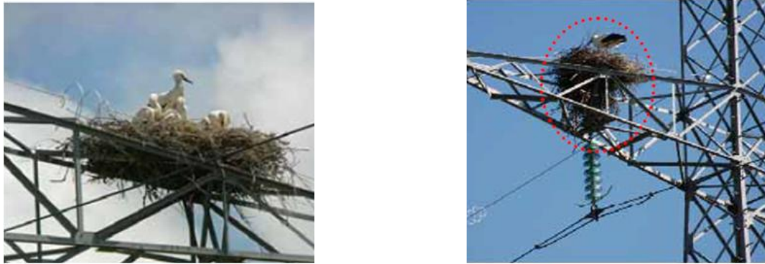
Figure 174 : Nids des cigognes installés sur des pylônes électriques
