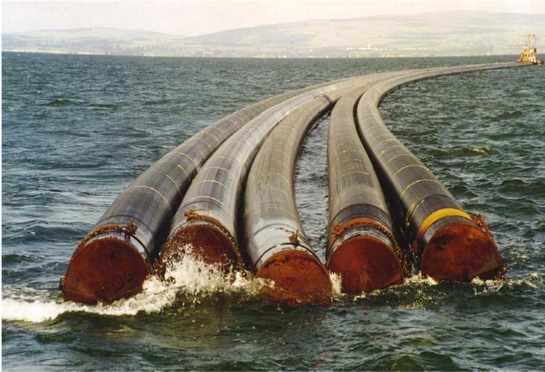
Figure 145 : Mode de remorquage des conduites sous marines du fournisseur vers le site de chantier
