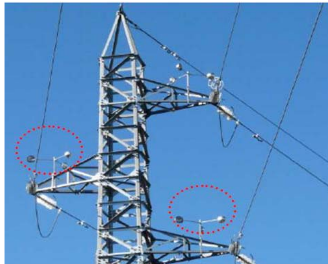
Figure 173 : Perchoirs artificiels fixés sur un pylône
