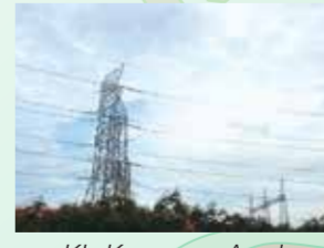
KL-Kampung Awah Transmission Line
