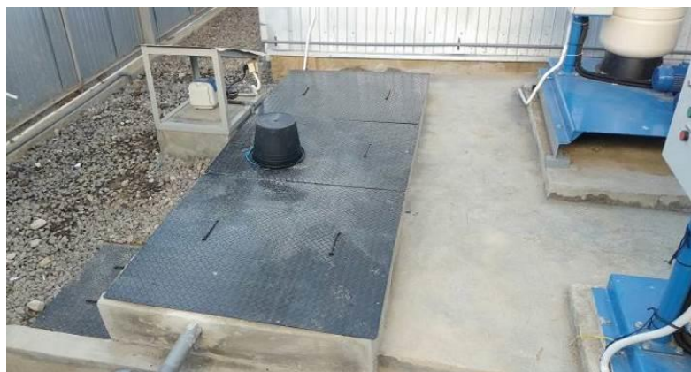
作業現場の仮設トイレ、 排水処理施設
