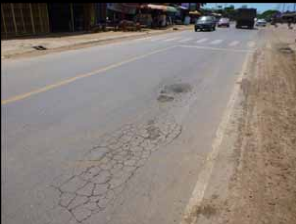
クラック及びポットホール箇所
