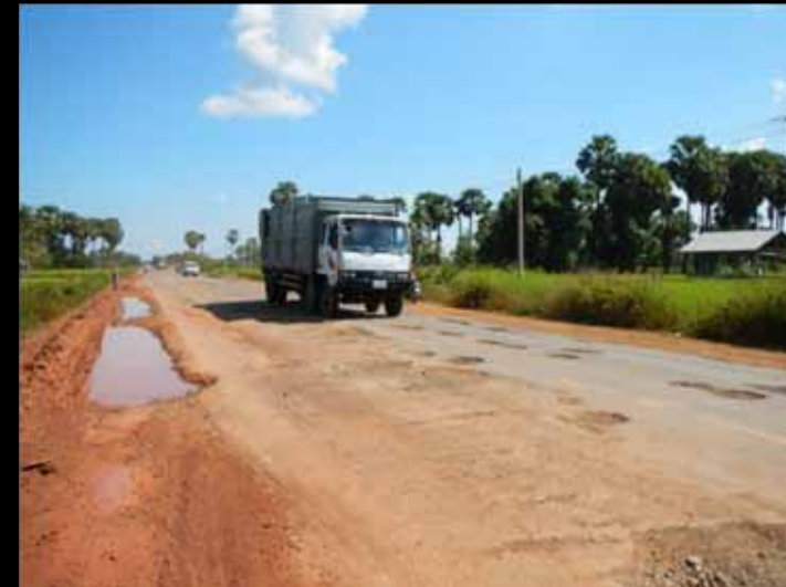
ポットホールによる通行困難な路面 (Kampong Chhnang州)
