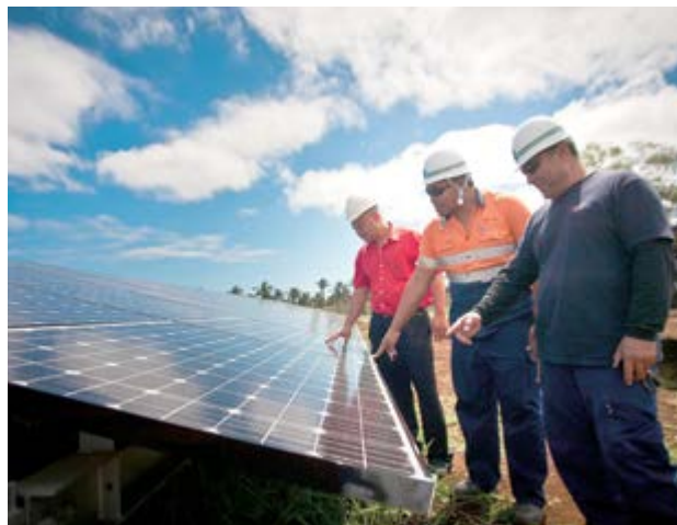
Installation d'un système de micro-réseaux grâce à un don dans les Tonga.
