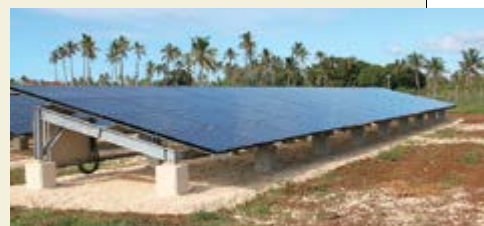
Une installation de production d'énergie solaire dans les Tonga.
