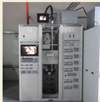
Équipement de transmission numérique SDBA (Photo : Yachiyo Engineering Co., Ltd.)
