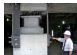
Un dispositif d'isolation parasismique fixé à un pylône sous un bâtiment municipal d'Arakawa.
