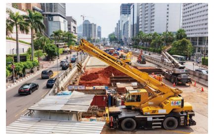
日本のODAで進むジャカルタ都市高速鉄道の工事現場
