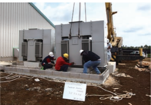
各地域に効率よく送電するために必要な変圧器の役割を果たすトランス盤を設置
