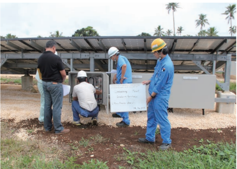
太陽光パネルの配線状況を現地の作業員と共に確認しながら試運転
