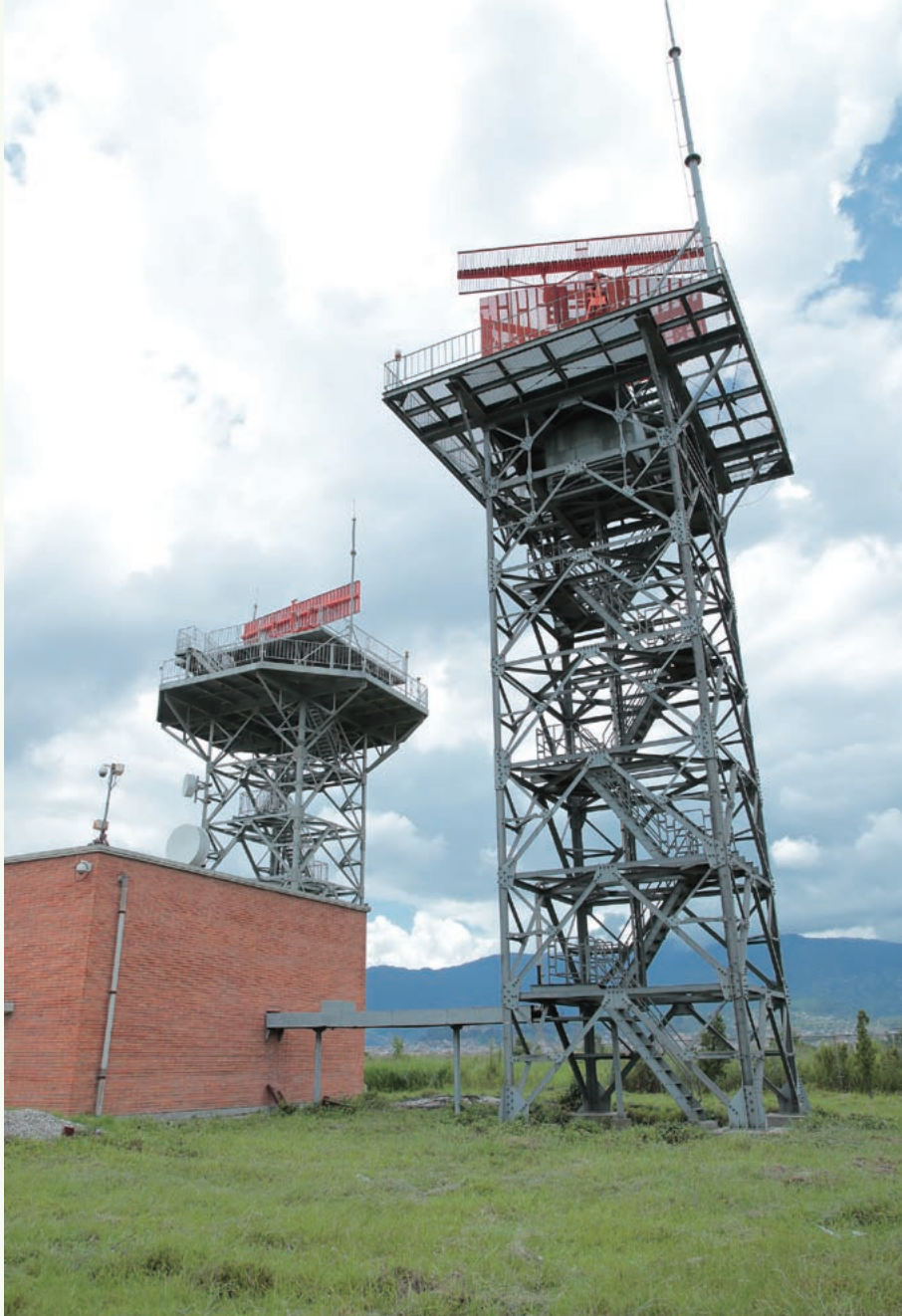
最初に作られた空港監視レーダー(右手前)と、今回新たに追加されたもの(左奥)
