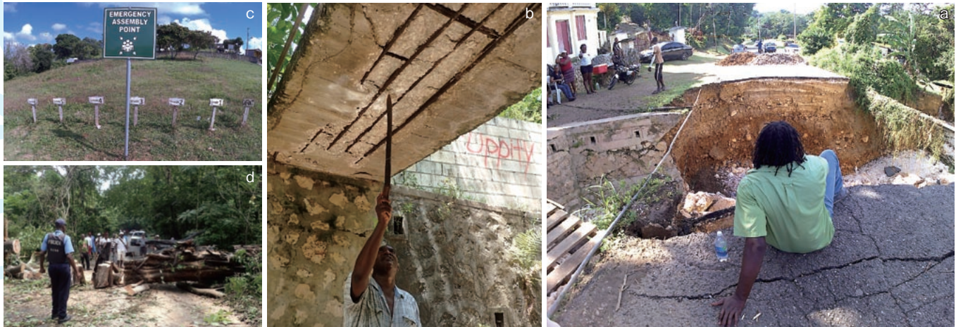
a.大雨の後に陥没してしまった道路。ハリケーンの通り道でもあるジャマイカでは、水害は身近な災害だ b.用水路にかかる石橋の強度を調べる同僚のアルヴィン・クラークさん c.各地域にある緊急避難場所。笹森さんは、GPSを活用したマップ化で効率的な避難などの実現を目指している d.倒木のために通れなくなってしまった道路
