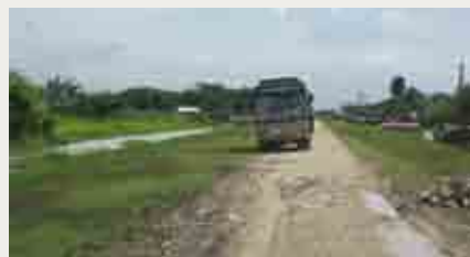
舗装が貧弱なので雨が降るとすぐに穴があき、でこぼこになる道路。走行中のバスが傾いてしまうことも。
