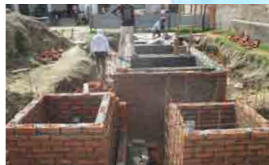
消化槽の施工風景。資材の大半は現地調達が可能のため設置コストも低い。
