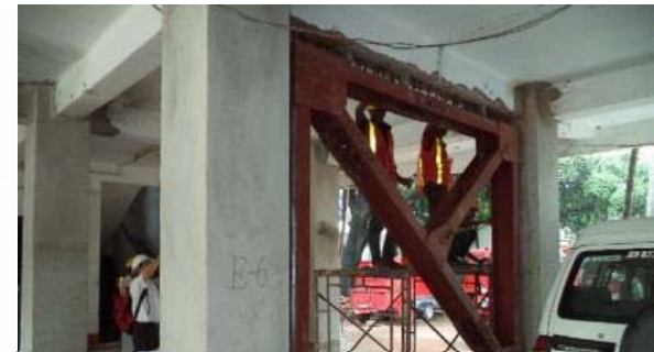
鉄骨ブレースでの補強も容易でない(バ国ODA事例, 2014)
