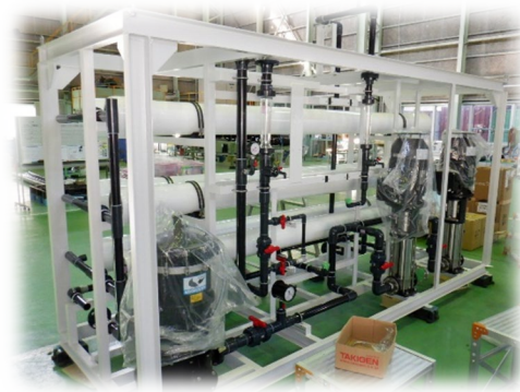
RO membrane unit
