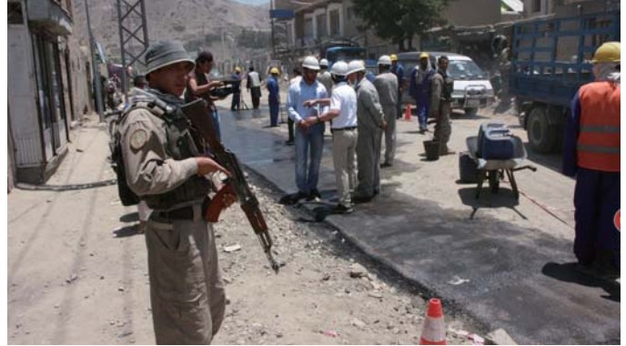
写真提供:レイモンド ウィルキンソン 破壊された道路を整備する日本の専門家チーム
