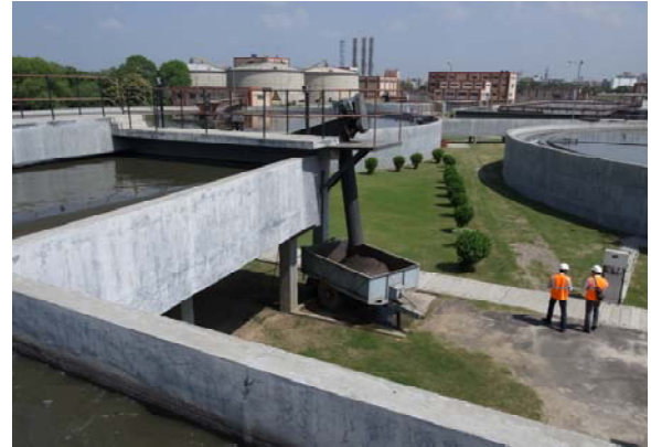
出所：筆者撮影 奥に向かい工程進む、汚泥で発電も行う（奥のタンク）
