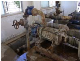
محطة ضخ مياه في الطفيلة
