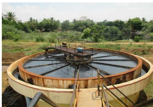
現地の生活排水処理施設
