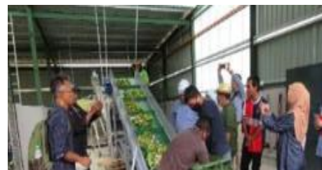
現地に設置した堆肥化設備
