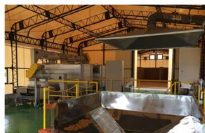
北九州エコタウンリサイクルセンターの様子
